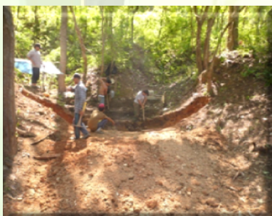
การขุดดินปรับแต่ง Slope ฝายและขนย้ายดินไปผสมดินกับซีเมนต์
