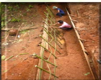
ขุดดินช่วงร่องแกนฝายและตอกไม้ไผ่เพื่อเสริมรับแรง
