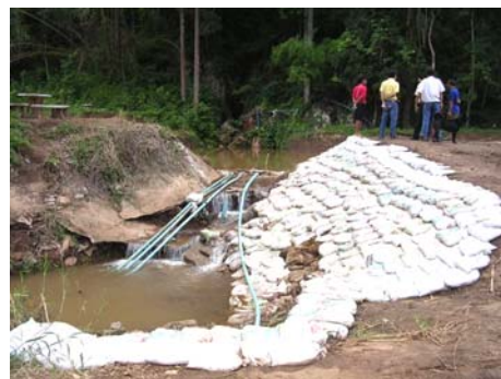
อาคารระบายน้ำจากสระเก็บน้ำ เดิมเป็นฝายคอนกรีต และถูกกระแสน้ำกัดเซาะพังเสียหาย
